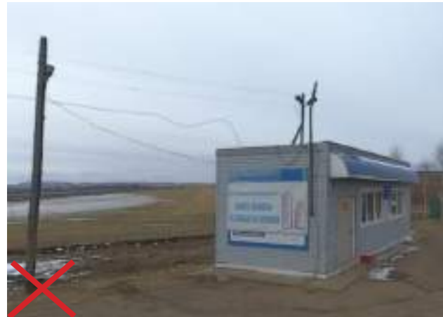
Недопустимо устраивать освещение с помощью прожектора на деревянной опоре и стойке на павильоне.
